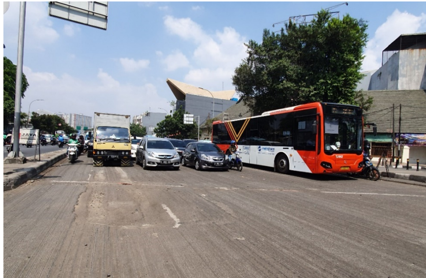
Gambar 3.1. Hasil foto liputan Jalan Jatibaru Raya yang bergelombang menggunakan ponsel
