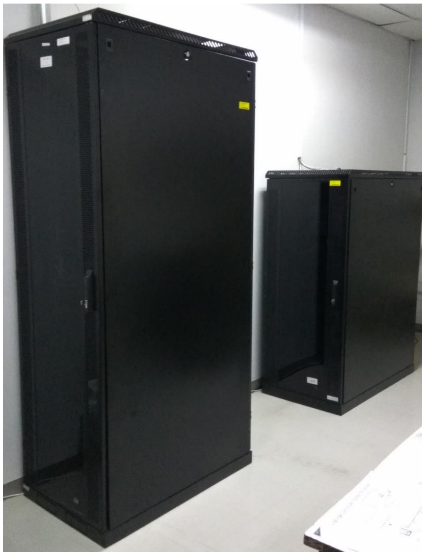
Gambar 3.7 Penempatan Rak Server
