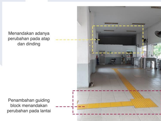
Gambar 1. 8 Kondisi bangunan Akses Masuk Barat Stasiun Tangerang (bagian dalam)
