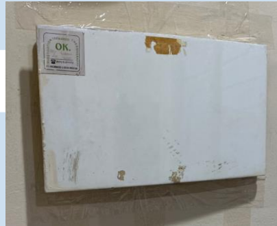
Gambar 3.11 Stopkontak di Area Luar Ruang Ibadah
