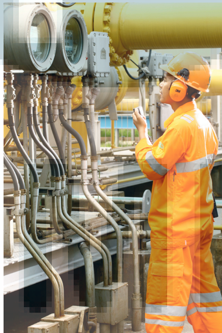
Gambar 3.1. Foto Pengecekan Rutin Indikator Tekanan Gas di Dalam Pipa
