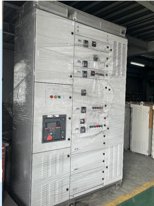
Gambar 2. 4 Panel listrik (Dokumentasi Pribadi)
