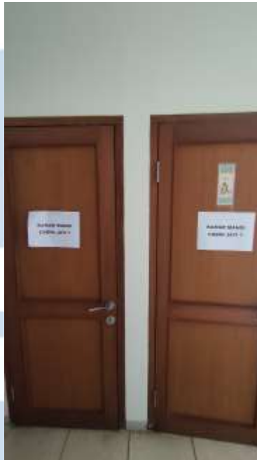
Gambar 3.23 Foto Signage toilet dan tanda toilet perempuan tidak ada
