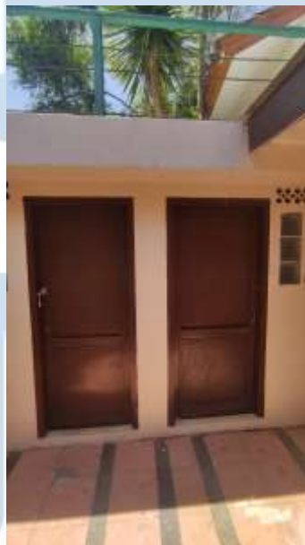
Gambar 3.28 Toilet yang tidak diberikan signage toilet sehingga membingungkan
