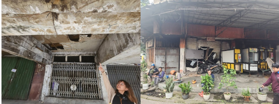
Gambar 3.6. Foto usang dan kerusakan toko yang terbengkalai di Glodok, Jakarta.
