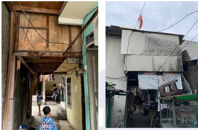
Gambar 1. 4 Kondisi Eksisting 1 gang yang tidak terdapat cahaya alami dan pembangunan ruang secara ilegal
