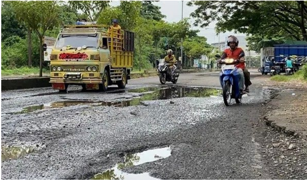
Gambar 1.1 Jalanan Rusak Akibat Overload dan Buruknya Sistem Drainase
