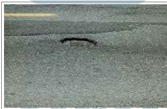
Gambar 2.2. Gambar Kerusakan Lubang
