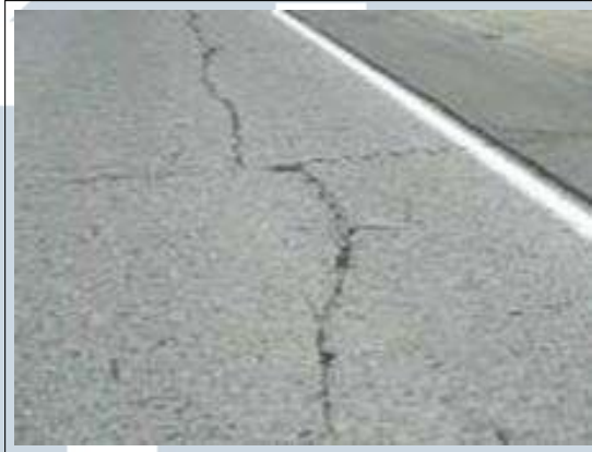
Gambar 2.1. Gambar Kerusakan Retak
